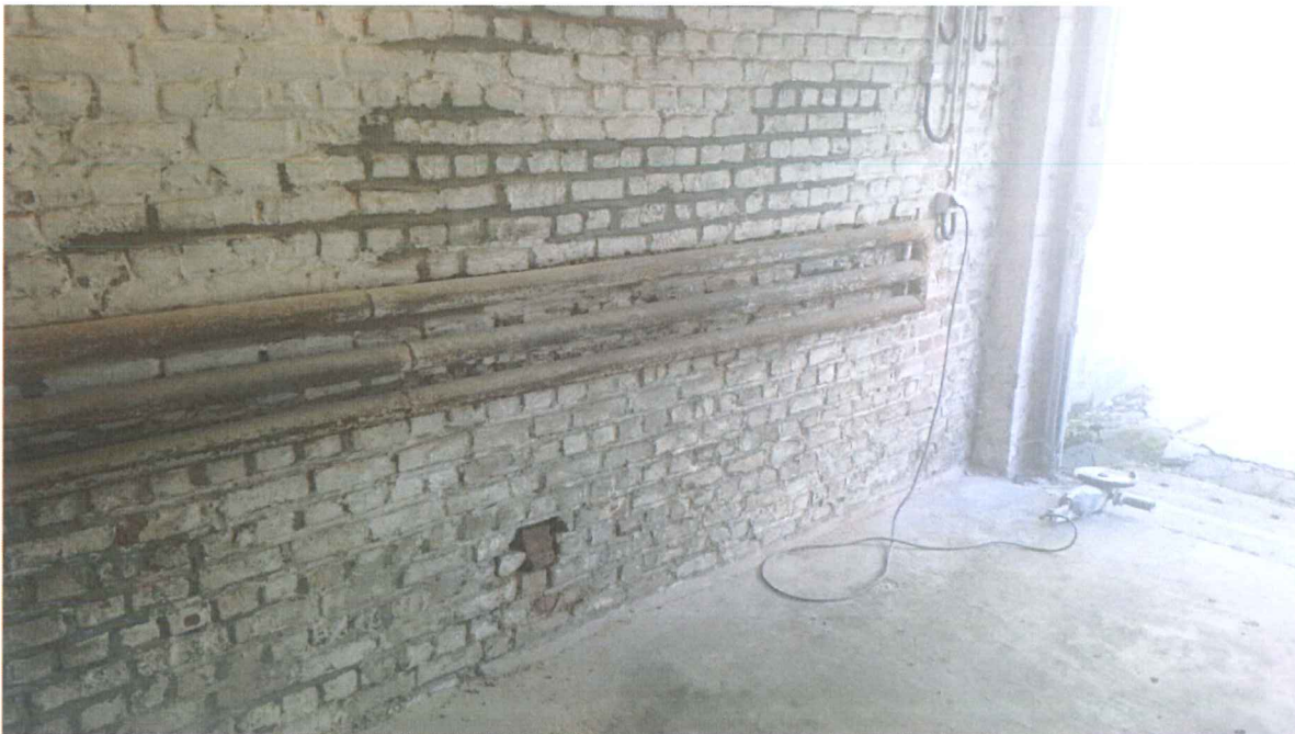
Mur mitoyen dont le renfort de fondation a été estimé nécessaire par le jugement
