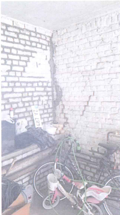
angle entre le mur de gauche, non concerné par le litige et le mur de droite mitoyen dont le renfort de fondation a été estimé nécessaire par le jugement
